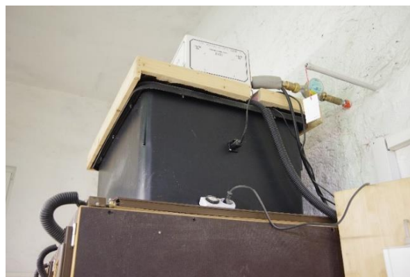
Abb. 27: Thermobehälter als Ausgangspunkt für die Ringleitung im Betrieb B
